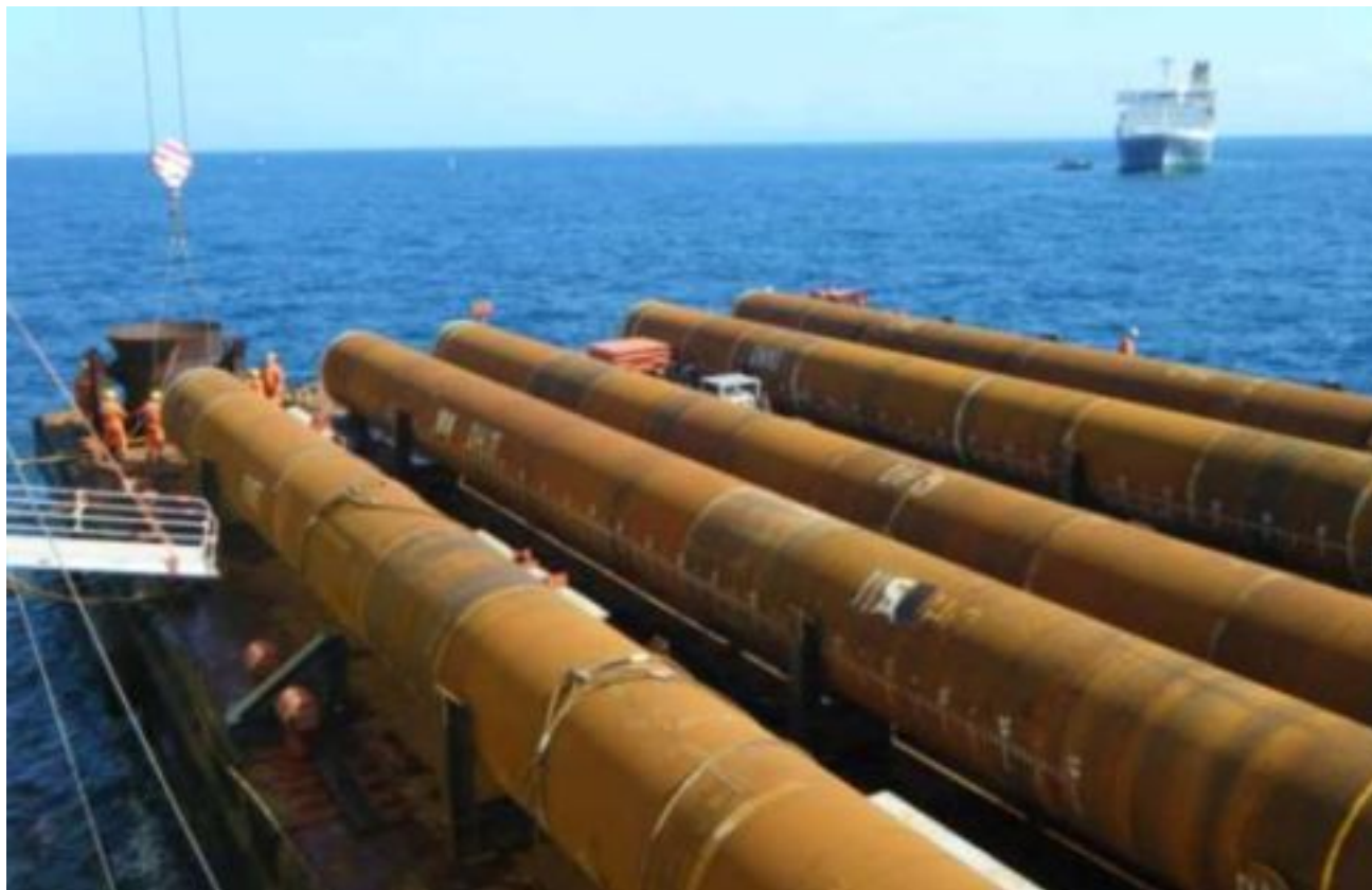
Sopra: Casings a bordo del pontone Mak pronti per l'installazione sulla dima per la piattaforma 2
