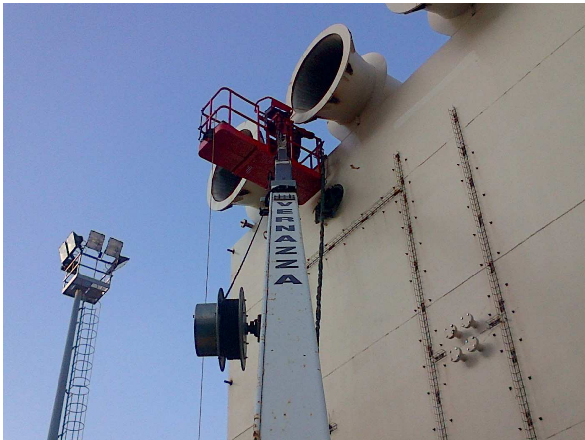
Sopra: Installazione rinforzi sui tubi guida catene dei cassoni di spinta nel cantiere di Livorno
