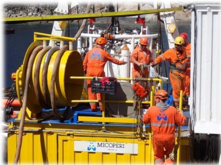
Gli ultimi controlli prima dell'ingresso in acqua della campana per le immersioni in saturazione
